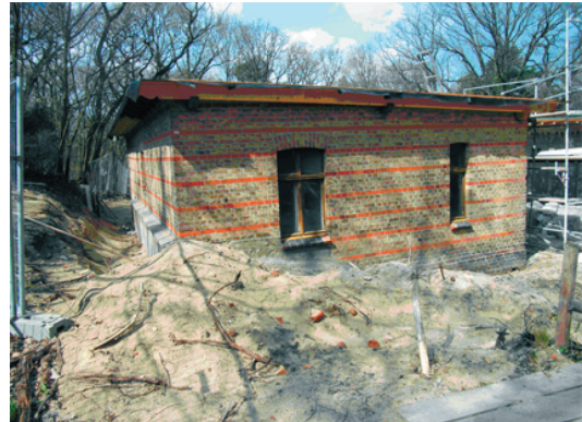
Abb.: Das ehemalige Waschhaus des MPO und zukünftige Museumsgebäude während der Sanierungsarbeiten.
